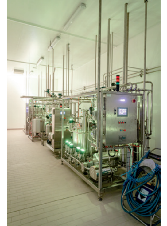
L'impianto di pastorizzazione
